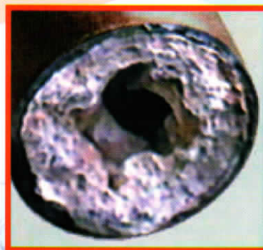
Wasserleitungsrohr mit Inkrustation
